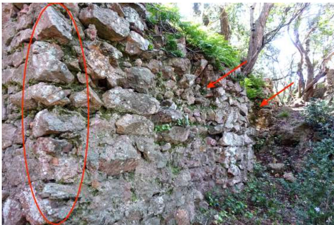
Fig. 30 : Passage nord et dégradation du parement extérieur
